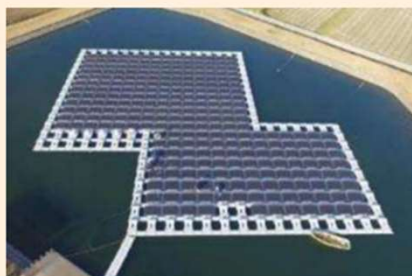
ため池フロートソーラー発電所
