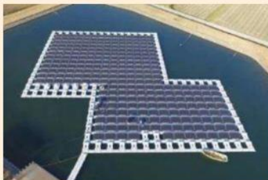
ため池フロートソーラー発電所
